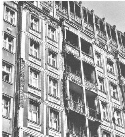
B46: Abschnitt C, Schadensbild der rückwärtige Fassadenseite, Richard Paulick
